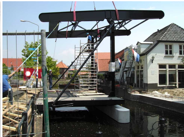
(overzicht inhijzen brugdelen door kraanbedrijf)
